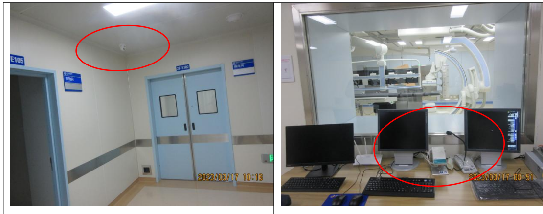
图 3-4 DSA 机房监视及对讲装置
